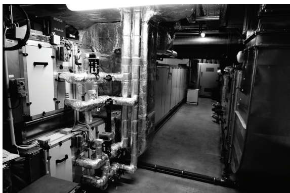
_Raumlufttechnische Anlage der Naturverwaltung Diekirch
