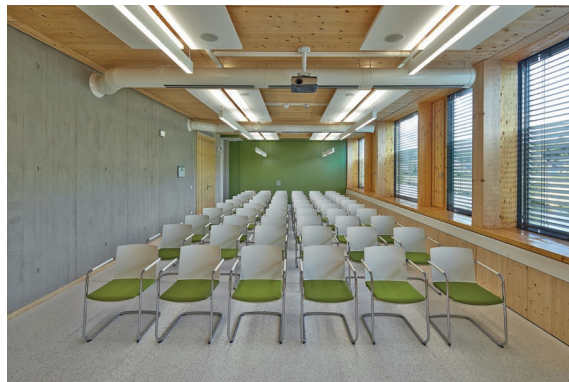
_Lüftungsauslässe im Konferenzraum
