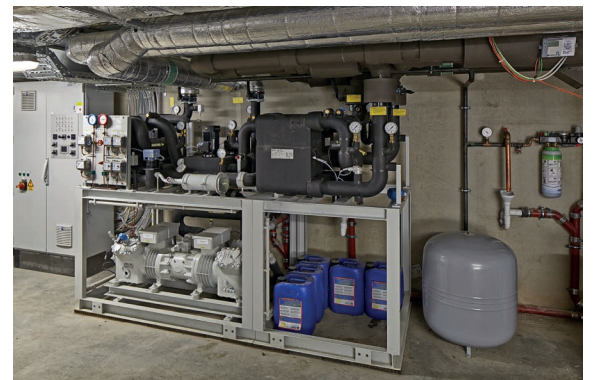
_Wasser-Wasser-Wärmepumpe der Naturverwaltung Diekirch
