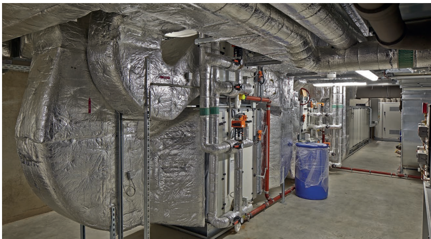
_Technikzentrale im Untergeschoss
